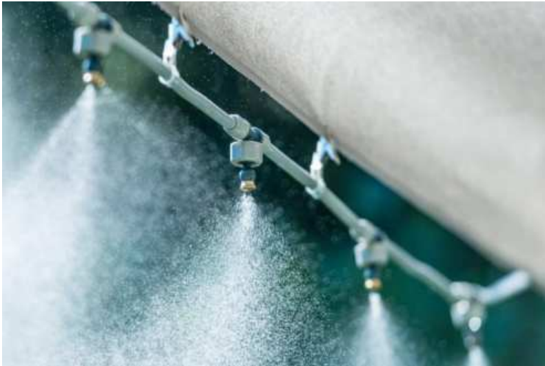
Réseau de buses d'aspersion type drencher, sur réseau d'un rideau d'eau
